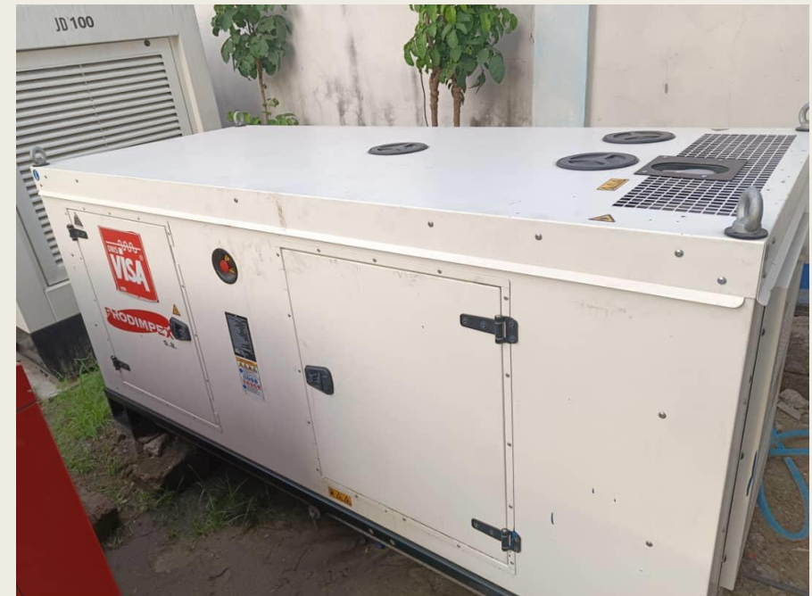
Groupe électrogène (100 KVA) pour Kinshasa
