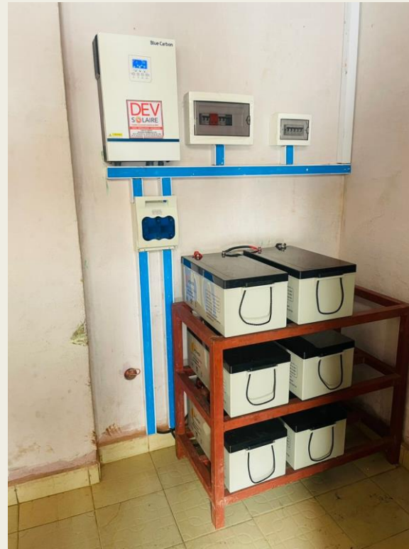
Batteries pour panneaux
